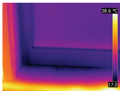
Figura 7.30 - Tubazione calda in prossimità dell'esterno, ponte termico della soglia
