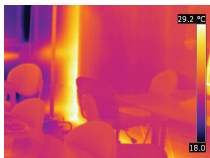
Figura 7.28 - Colonna montante dell'impianto termico sulla parete esterna, ma non ispezionabile perché nascosta dalla nuova tramezza
