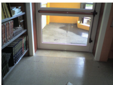
Figura 7.29 - Uscita di sicurezza
