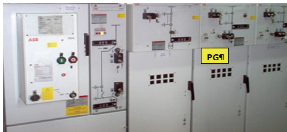
Figura 3.2 - Quadro elettrico di una cabina provvisto di Protezione Generale (PG)
